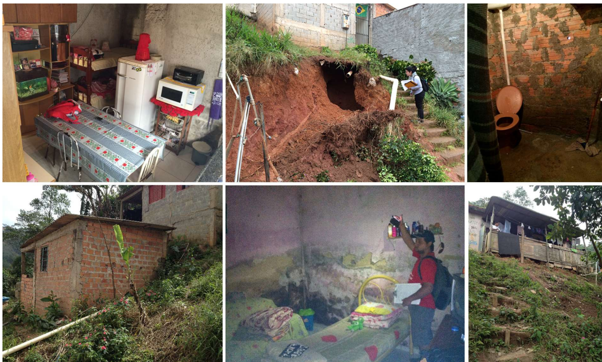
Figura 2 – Chafick: principais problemas encontrados nas casas
