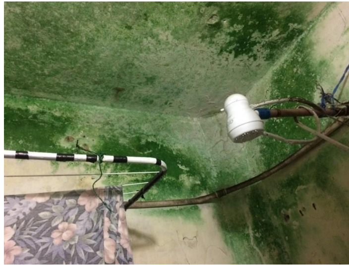
Figura 4: Área molha sem revestimento e com mofo
