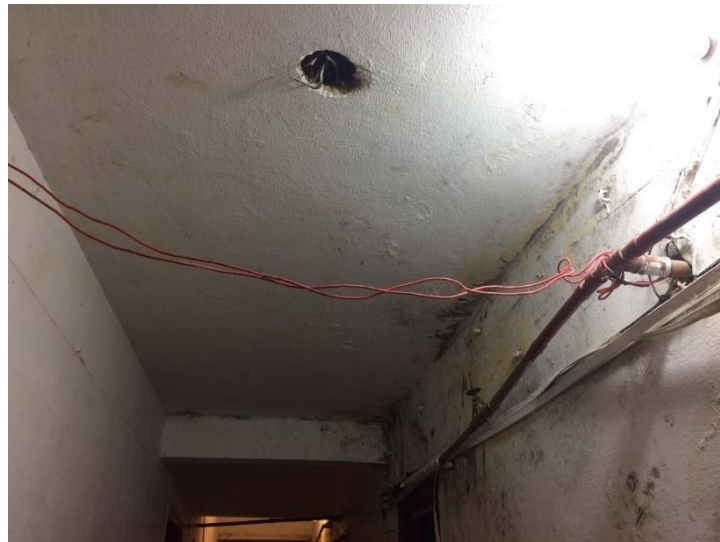
Figura 3: Fios expostos nos corredores da ocupação
