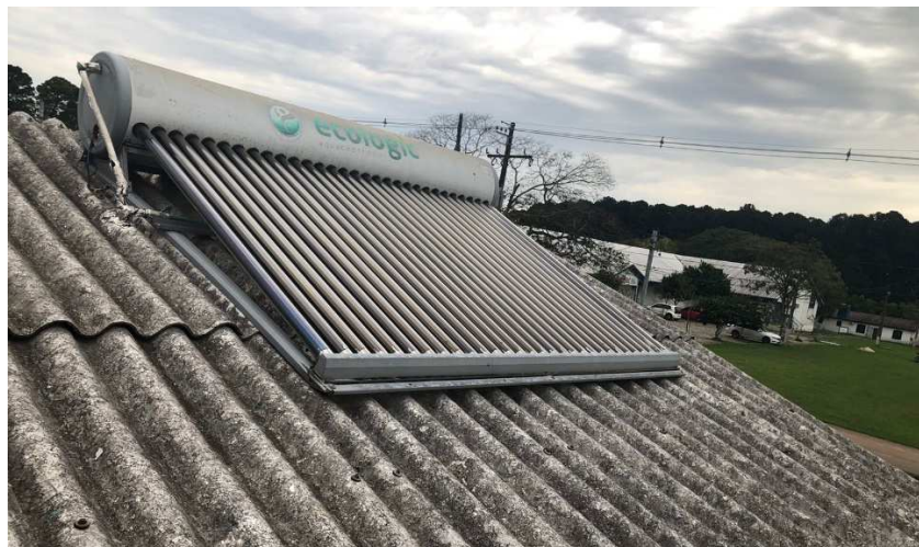
Figura 3. Aquecedor solar instalado no telhado da CPE.
