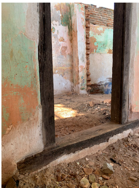
Figura 4: Situação das esquadrias e piso
