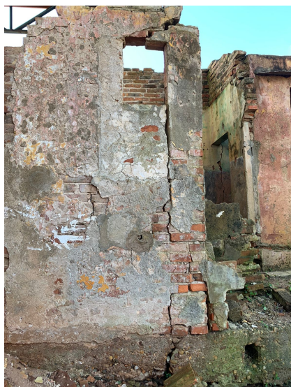
Figura 8: Fissuras e Rachaduras
