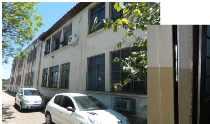
Figura 4: Fachada do Instituto Estadual Gomes Jardim, junta entre os dois prédios (2019), Guaíba/RS.
