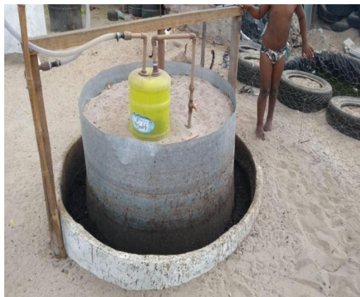
Figura 2 - Biodigestor finalizado e filtro instalado para a remoção de odores.
