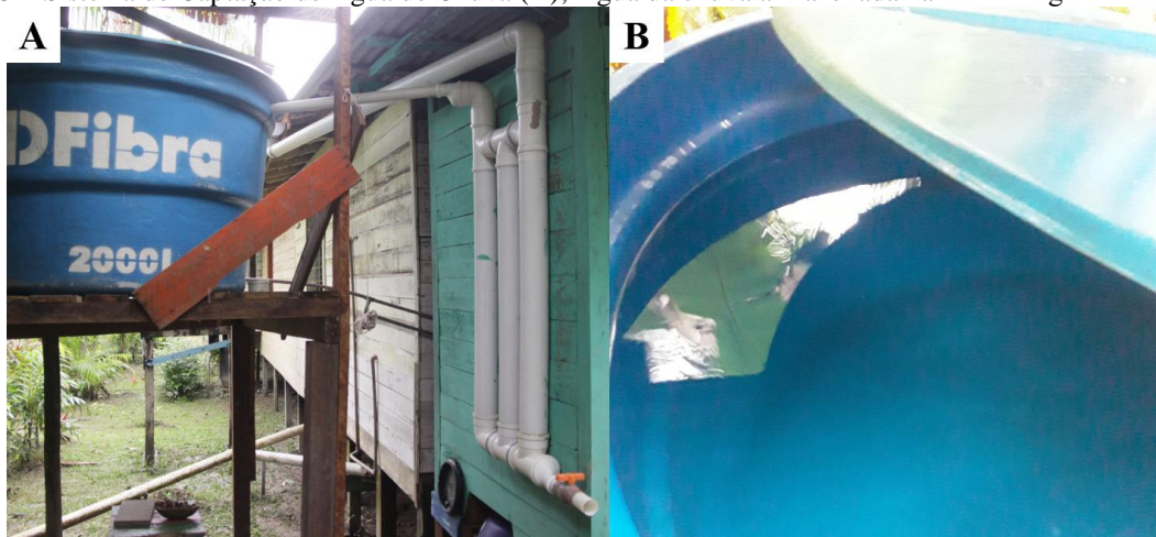
Figura 3 – Sistema de Captação de Água de Chuva (A); Água da chuva armazenada na caixa d’água do SCAC (B).
