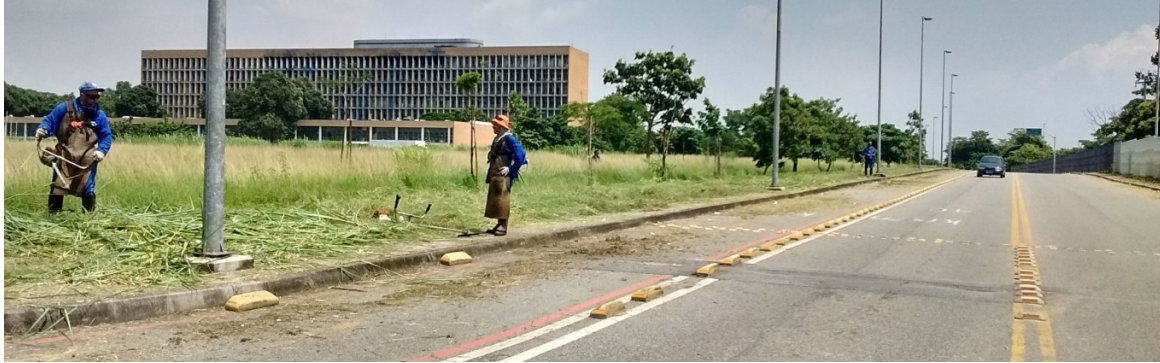
Figura 6- Ilha do Fundão. Roçada proposta no passeio, junto ao meio fio.
