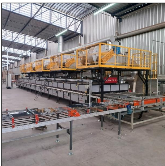
Figura 1. Secador de placas cerâmicas polidas operando.
