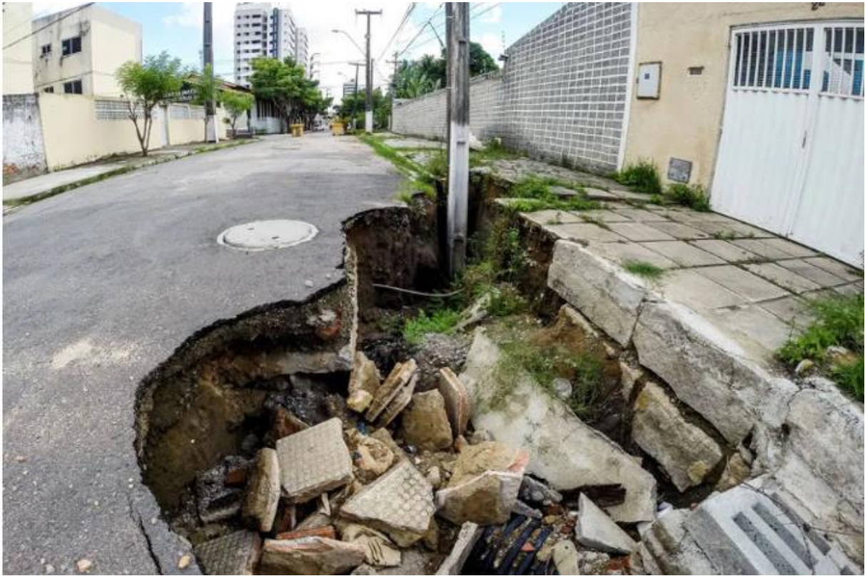
Figura 03: Buraco em rua do Pinheiro.
