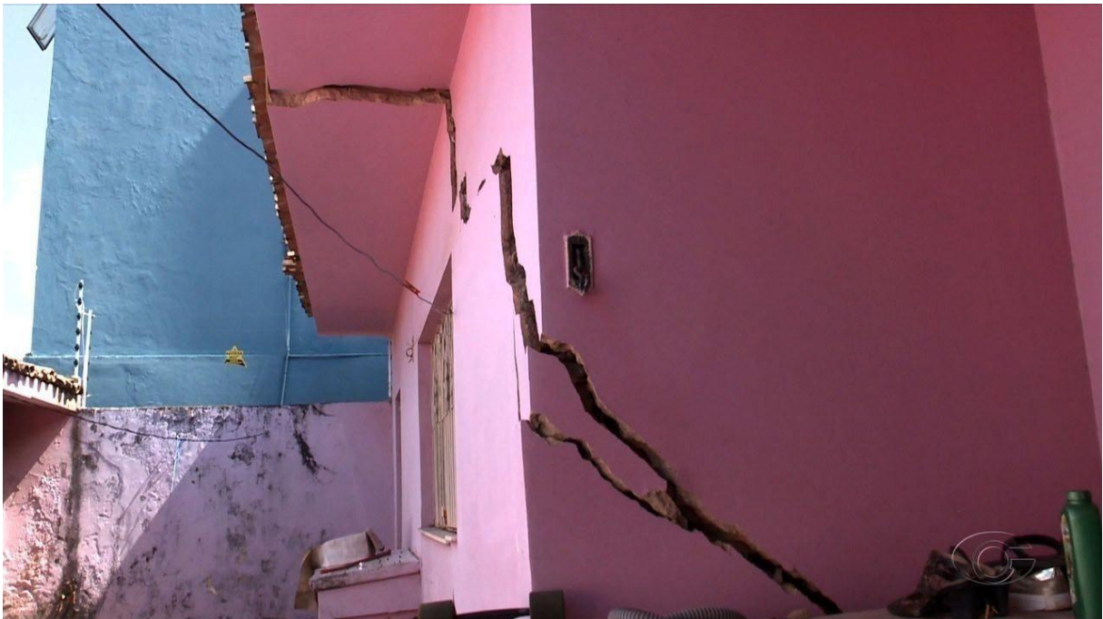
Figura 02: Casa rachada no bairro do Pinheiro.
