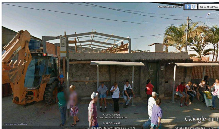
Foto 1 – Construção de imóveis comerciais no lugar de residências em meio ao comércio popular na Rua Padre Pedro Pinto – bairro Venda Nova, Belo Horizonte. Centralidade mais expressiva do Vektor Norte da RMBH. Fonte: Banco de Imagens do Google Earth – imagem de 07/2011.
