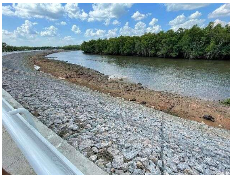
Figura 6: Resto de aterro e marcas do início de assoreamento da margem do rio Maguari.
