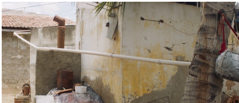
Figura 15: Sistema de abastecimento de água em residência
